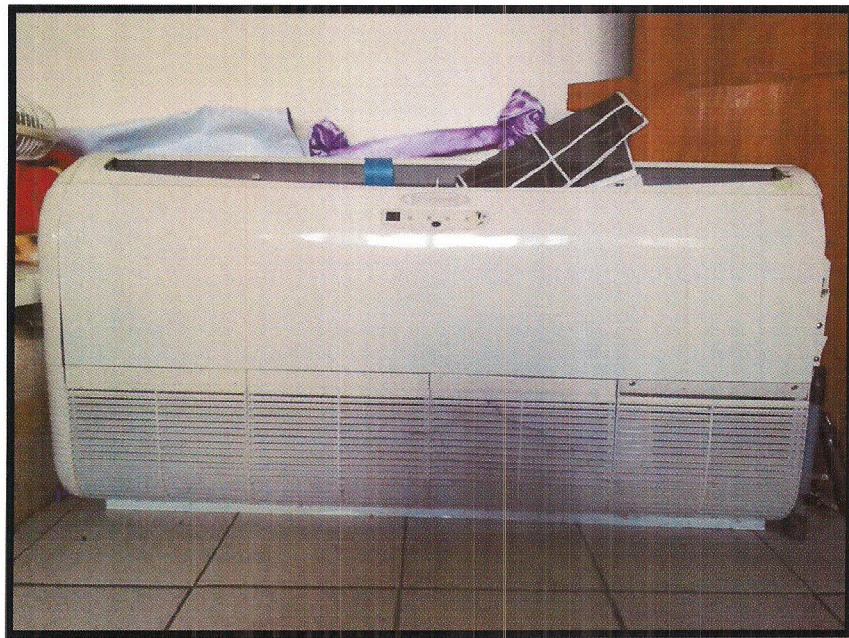
เครื่องปรับอากาศ ขนาด ๒๕,๘๐๐ BTU ยี่ห้อ เซ็นทรัล แอร์
